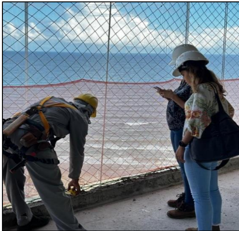
Figura 1 - Vista interna do pavimento com a instalação da rede piso a piso
