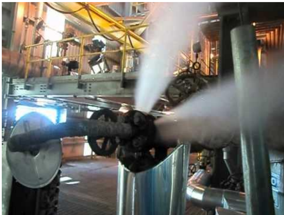
Figura 4 - Vazamento de produto entre flanges.
