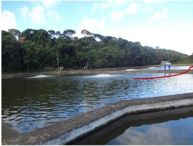
Figura 16 - Lagoas de estabilização ETE 2
