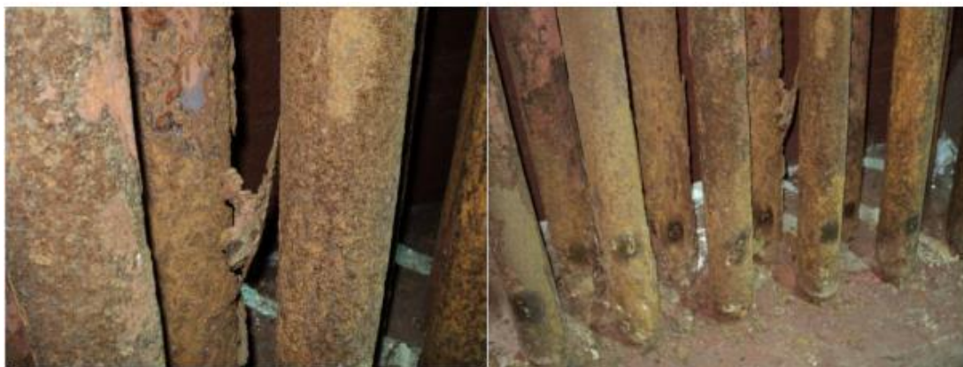
Figura 3. Fotografia das paredes externas da tubulação no interior da caldeira, mostrando o desprendimento de produto de corrosão após o abaixamento e controle da umidade por aquecimento 15
